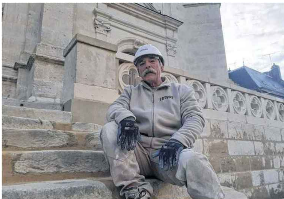
Alain Trassard sur les marches de l'église entièrement refaites. Déplacées puis réinstallées.
